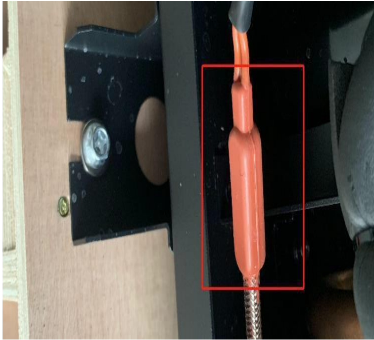
Elektrische Gestellheizung D08
